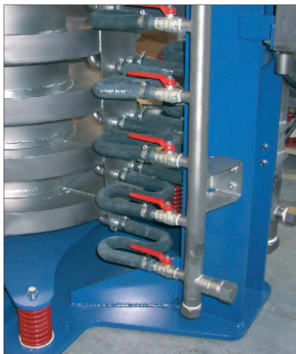
Bild 23 Kühlwasserversorgung eines wassergekühlten Wendelförderers
